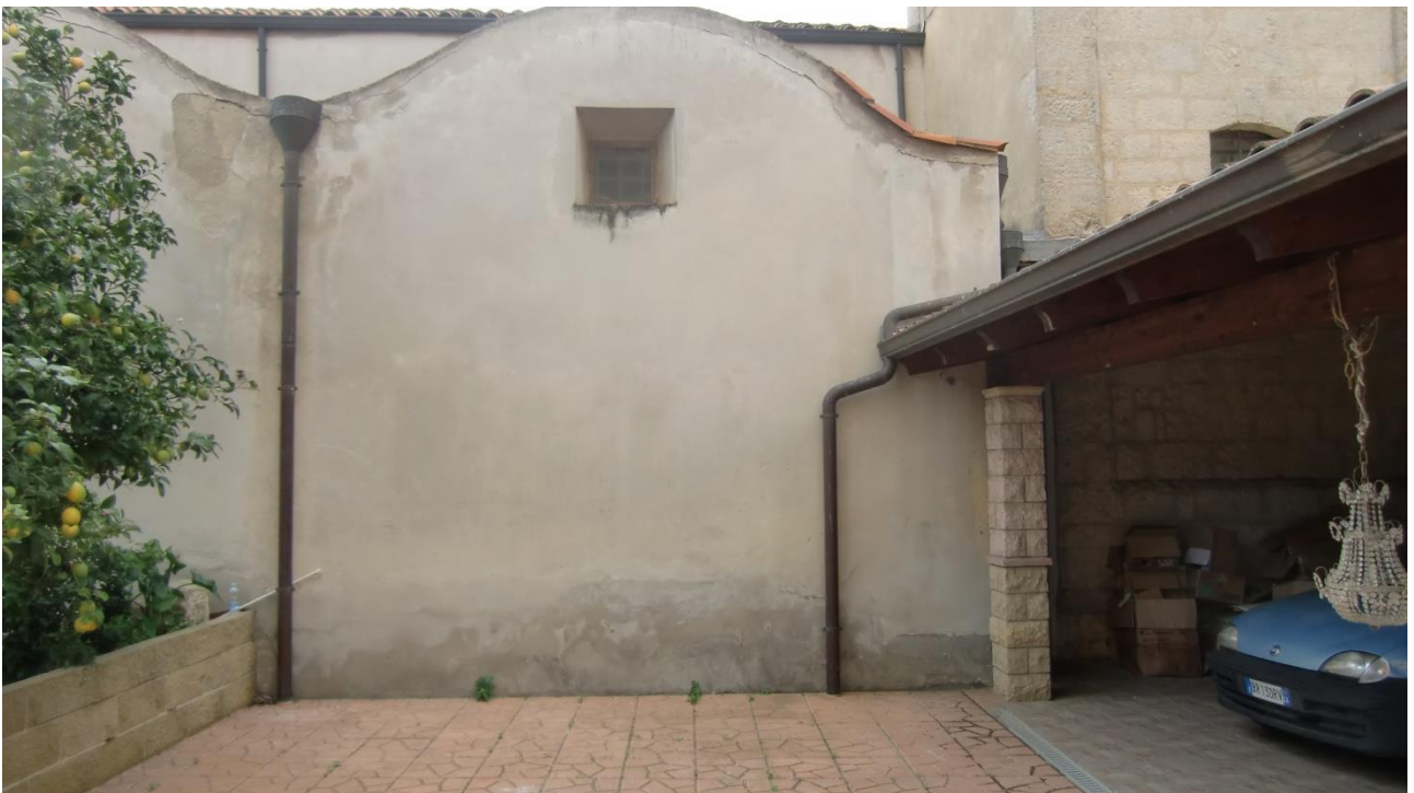
Foto 12 - Vista cappella lato sinistro: in chiara evidenza la traccia dell'umidità ascendente
