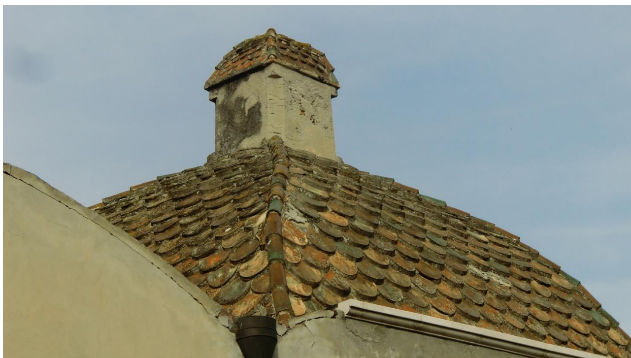
Foto 24- Particolare copertura nervata sulla sacrestia: in evidenza lo stato del degrado complessivo.
