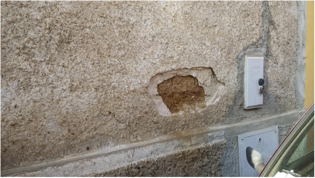
Il degrado degli intonaci delle murature esterne
