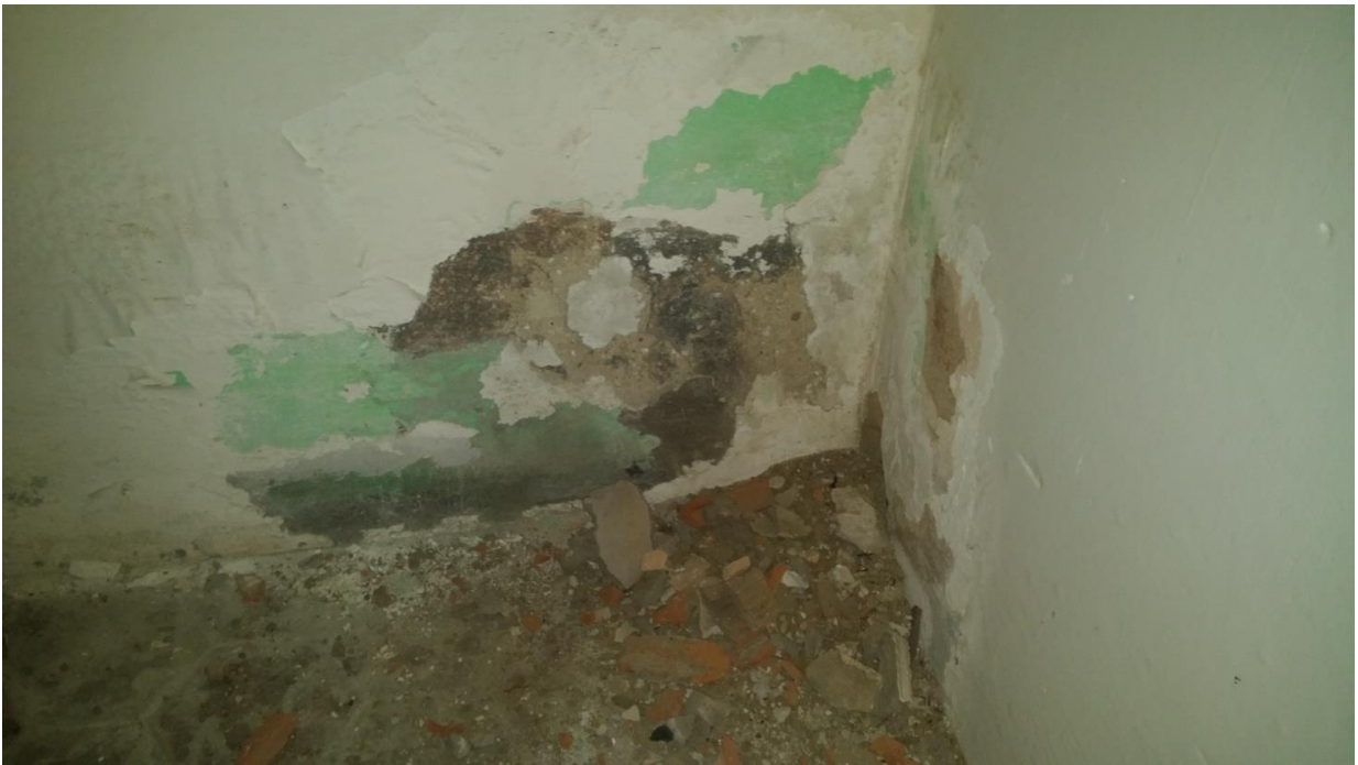
Umidità ascendente dalle fondazioni
