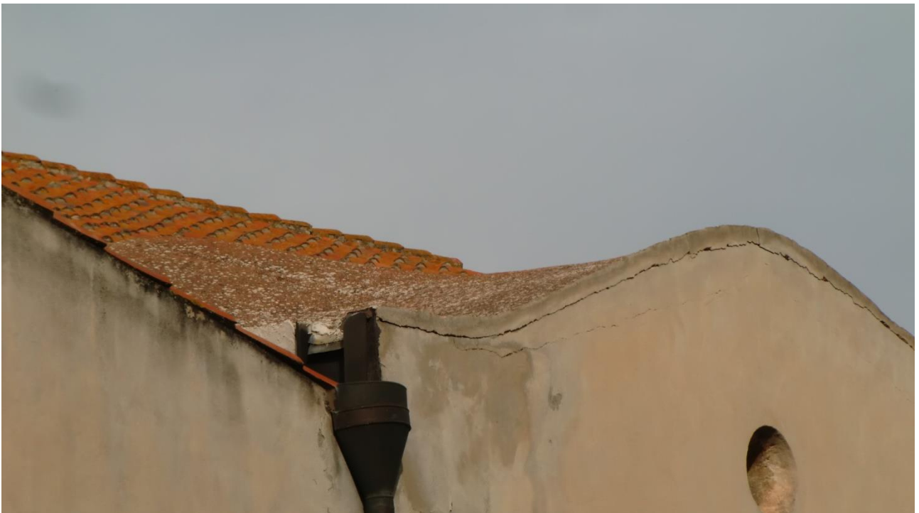
Foto 22 - Particolare del compluvio fra coperture di diversa natura.
