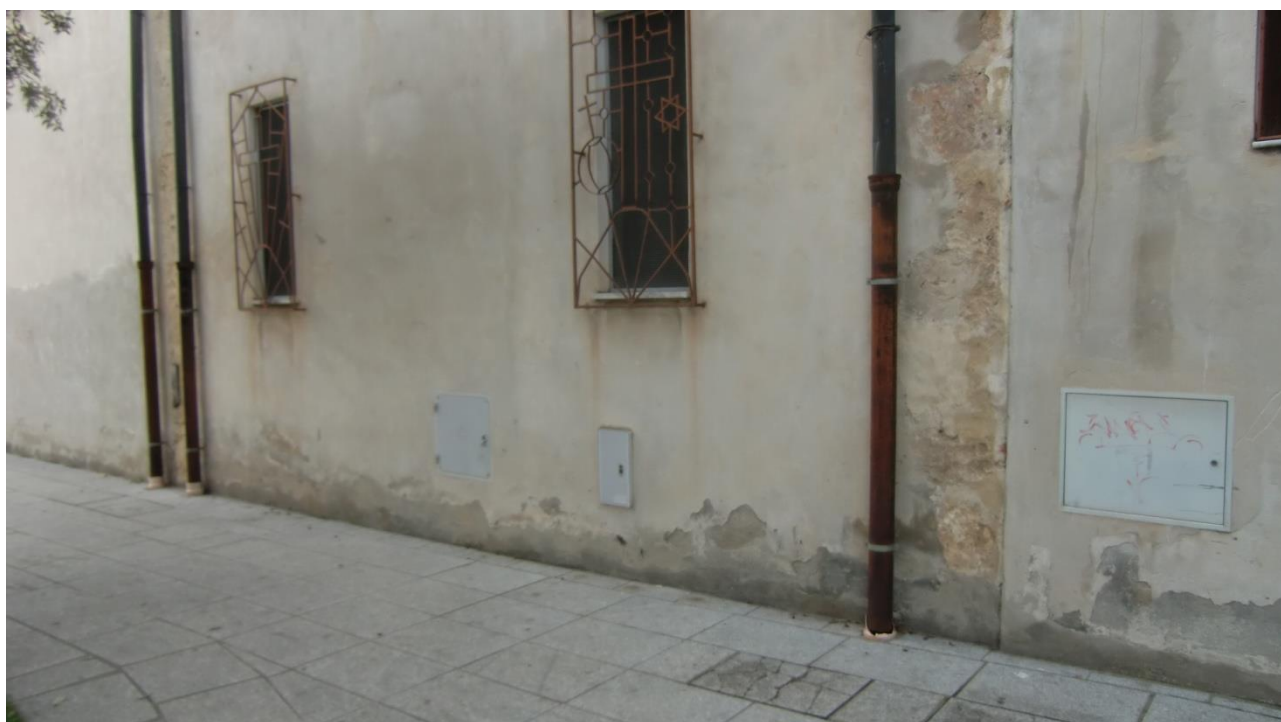
Foto 16 - Particolare del degrado da umidità ascendente.
