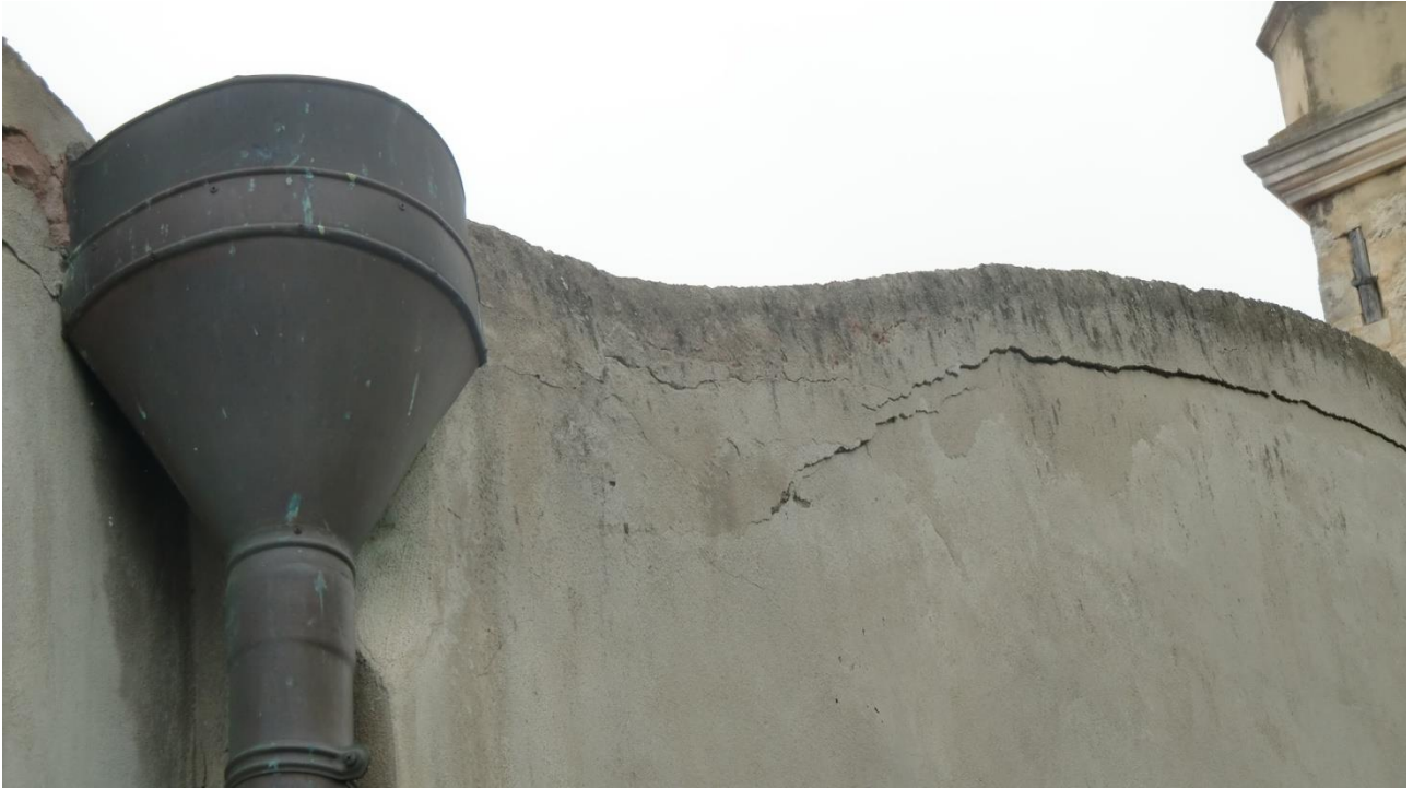
Foto 13 - Particolare innesto pluviale sul compluvio delle volte a botte.
