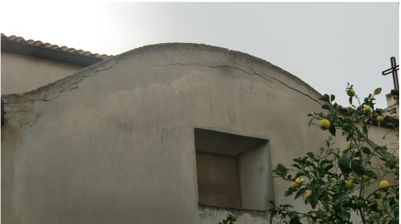
Foto 14 - Particolare delle lesioni in copertura.
