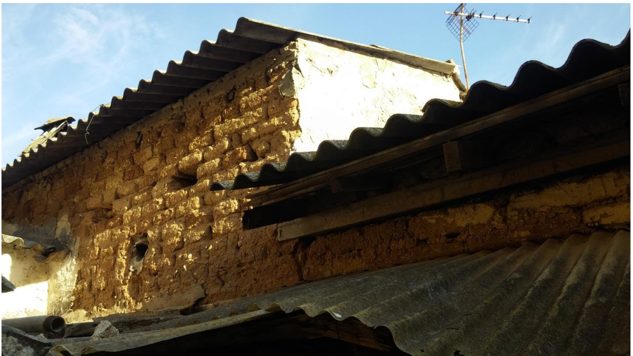
Particolare prospetto interno e copertura in cemento-amianto da sostituire
