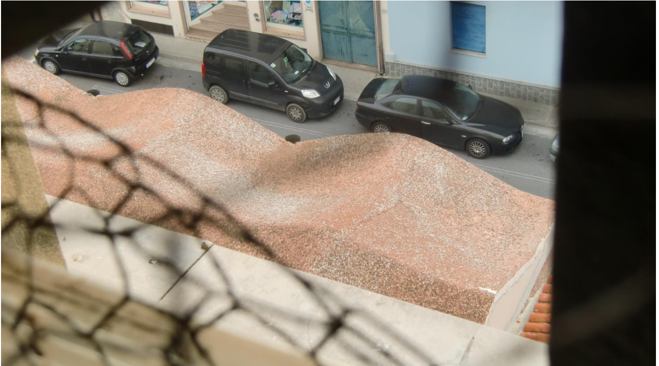
Foto 21 - Vista superficie estradossata delle volte a crociera sulle cappelle del lato destro: in evidenza la non rispondenza alla geometria propria delle volte a crociera.
