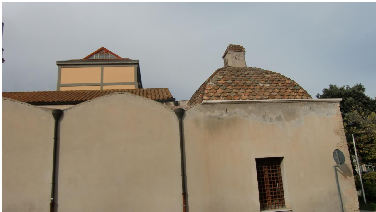
Foto 23 – Discontinuità fra l'architettura delle cappelle e quella della sacrestia.
